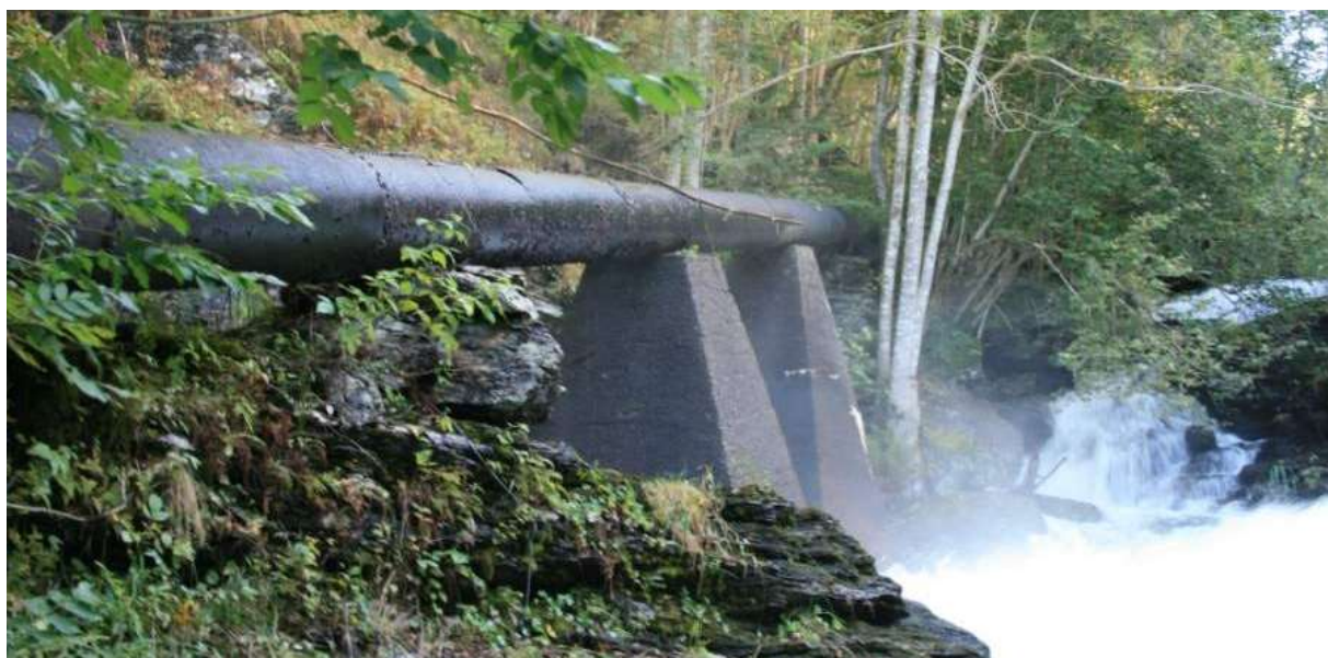
Figur 5. Her ser ein restar etter eit lite kraftverk som var i drift i åra frå 1914 og fram til om lag midten av 1950-talet. (Foto; Karl Johan Grimstad ©).
